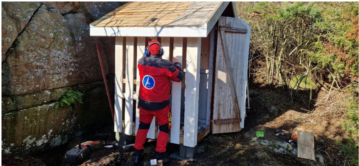
SGT i arbeid med rehabilitering av toalettbod på Alholmen ved Seilø (Fredagshølet) 2023
