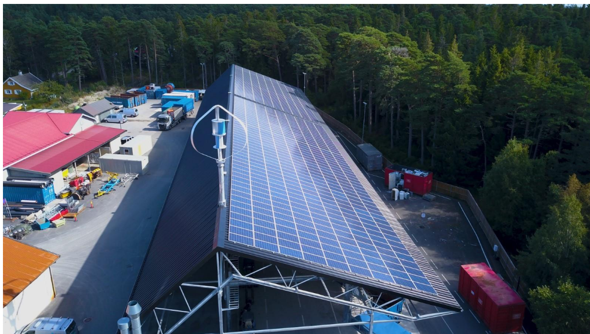
Sandbakken miljøstasjon med solcellepanel og vindmølle
