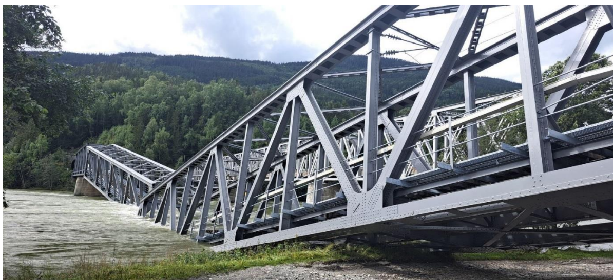
Foto 3. Randklev jernbanebru kollapset. Foto: Bergens Tidende
